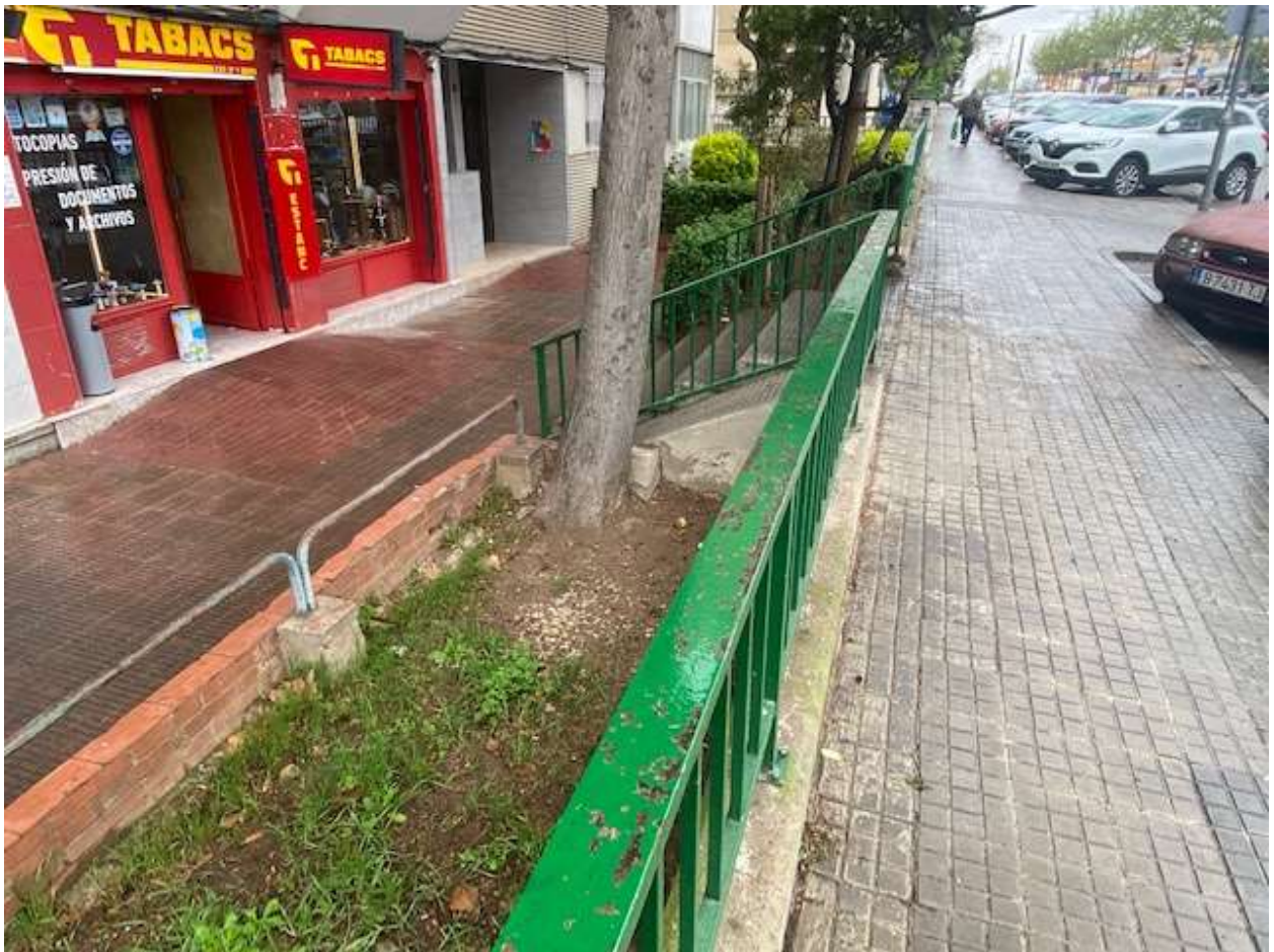
Millora de l'accessibilitat a l'Av. Cantàbric 25-31 / Oficina Tècnica Territori / Ajuntament de Badia del Vallès
