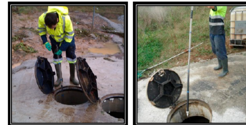
Fig. 25. Inspección y medición de los niveles de lodo en el equipo Downstream Defender®.
