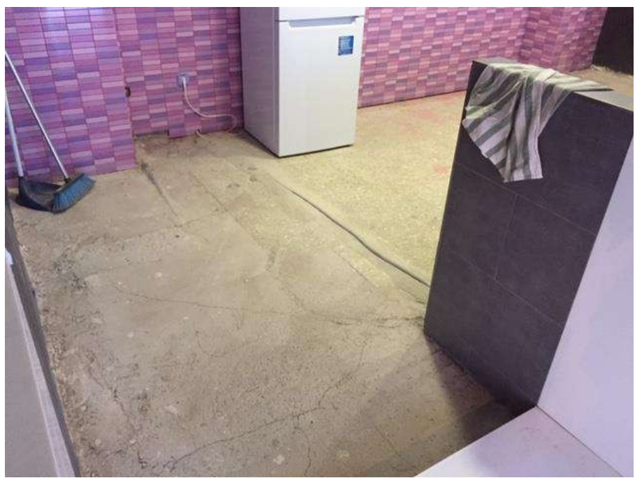
Es valora la reposició del paviment a la zona interior de la barra
